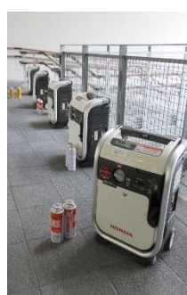
発電機の起動訓練の様子
